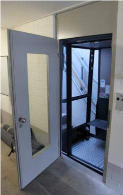
Station d'arrêt dans un garage avec porte à battant manuelle
